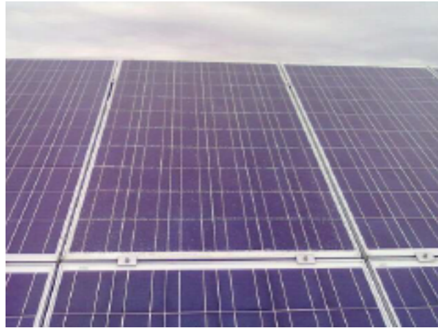
Tavola n. 21: Modulo con superficie compromessa
