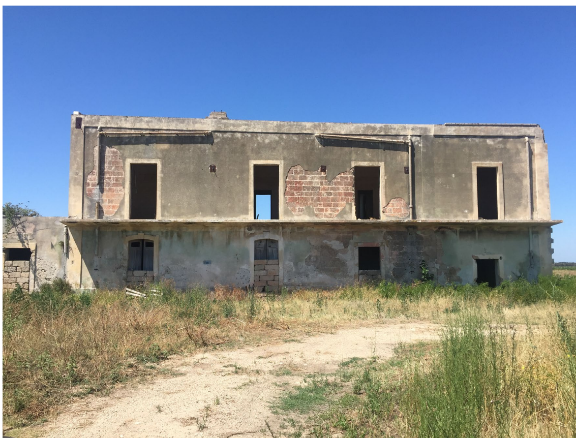
Figura 13 - L'edificio collabente interno alla recinzione di impianto
