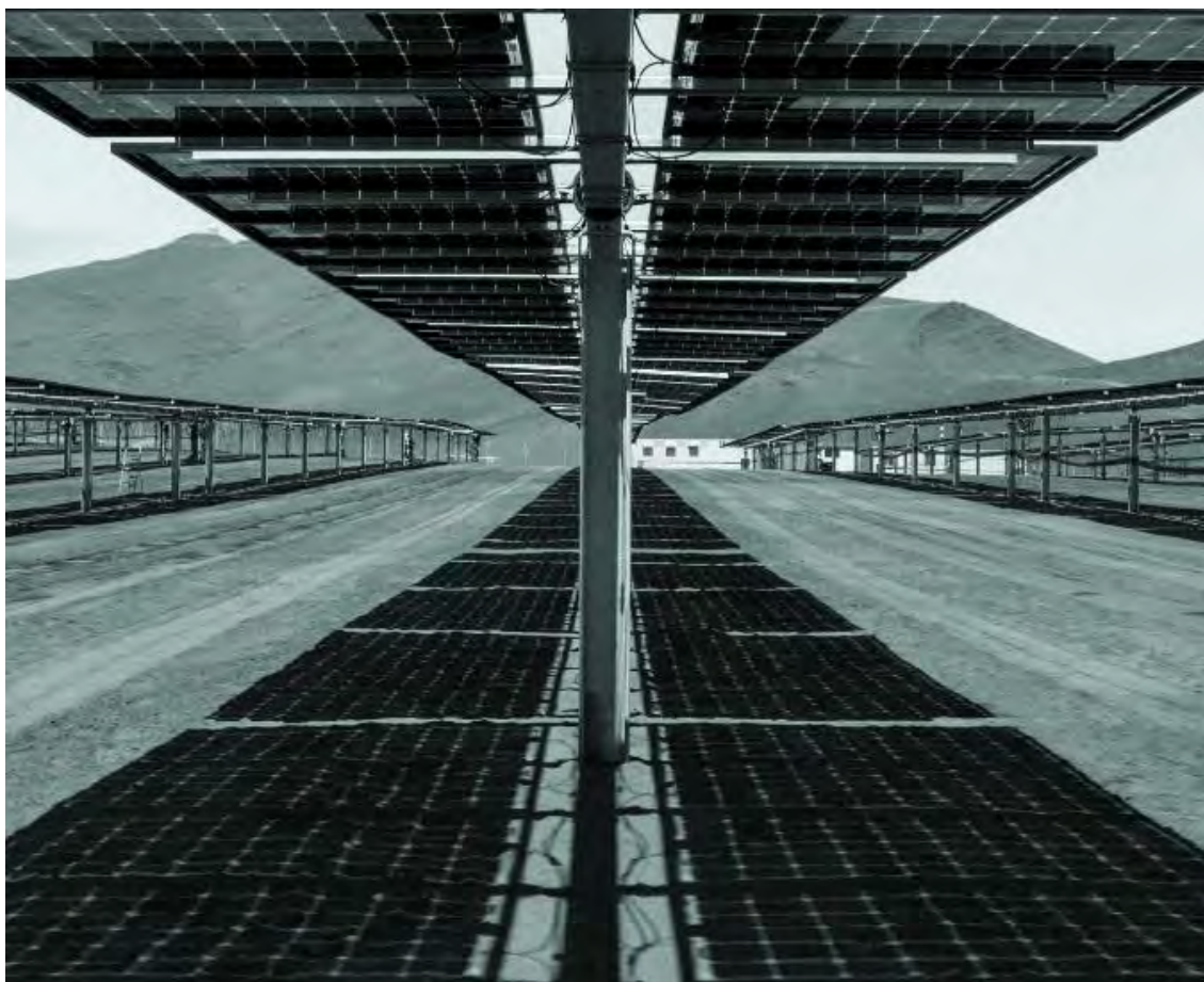
Foto 2: Superficie occupata dall'inseguitore monoassiale
