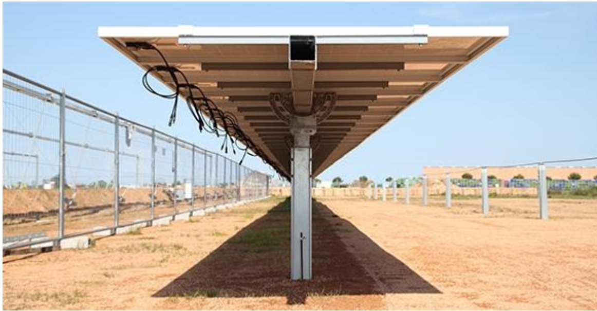
Figura 2 - Particolare di installazioni
