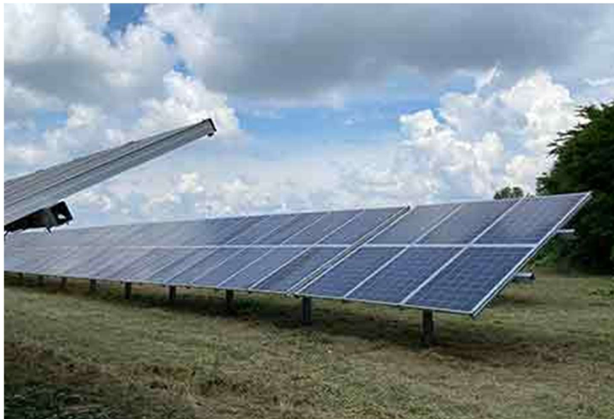
Figura 3.2: Particolare strutture di sostegno moduli
