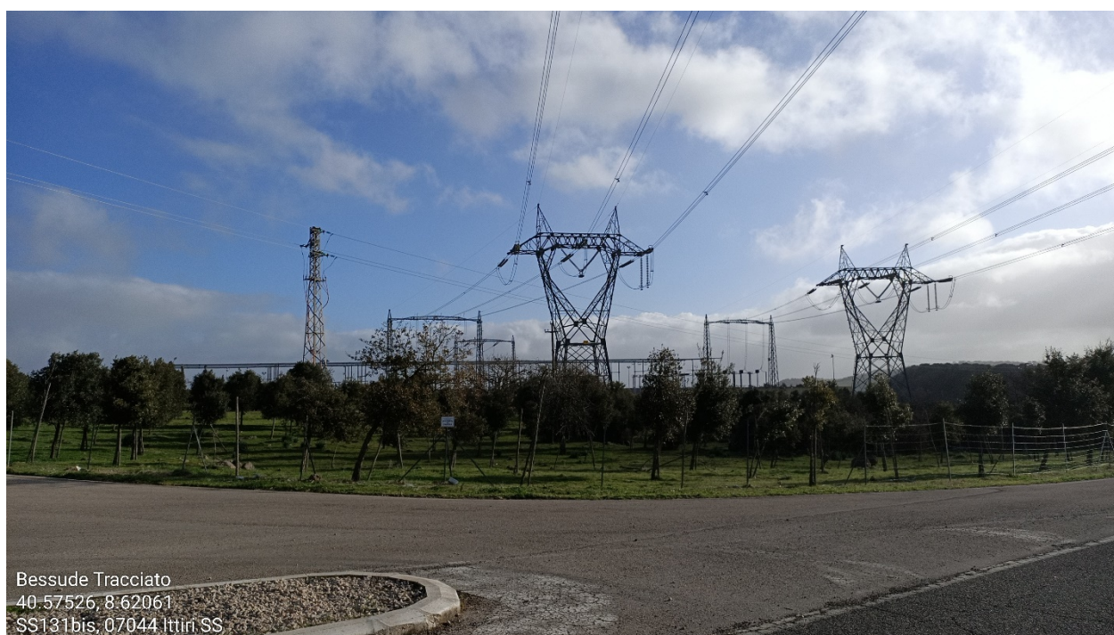
Ittiri, stazione Terna: punto interessato dalla prima tratta di cavidotto in progetto.
