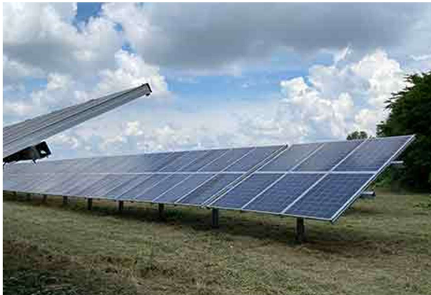
Figura 3.5: Particolare strutture di sostegno moduli
