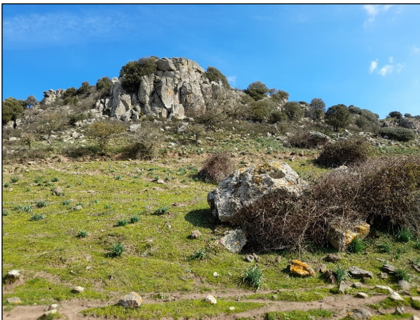
Figura 11: cornice rocciosa presente poco a nord del capannone dell'azienda agrozootecnica con blocchi di crollo alla base del versante.
