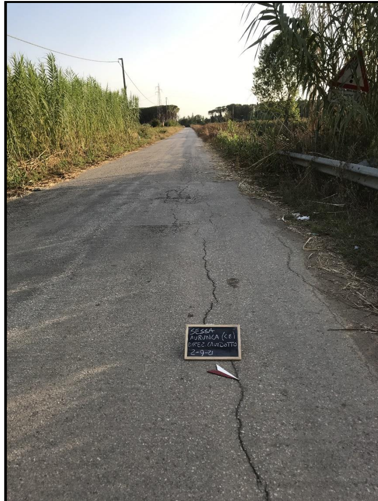
Fig. 61 - Dettaglio della strada sterrata, in cui verrà effettuato lo scavo per il cavidotto.
