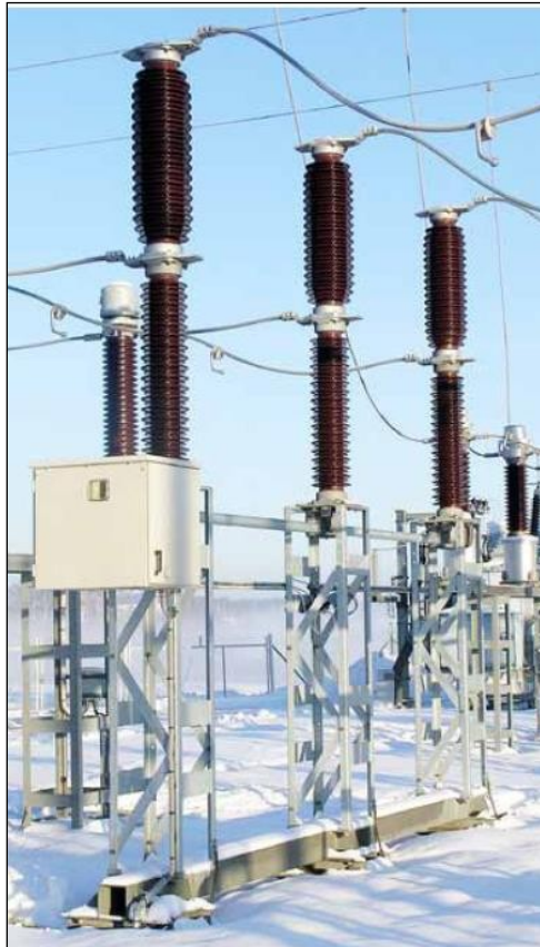
Fig. 15. Particolare Interruttore con TA incorporato.
