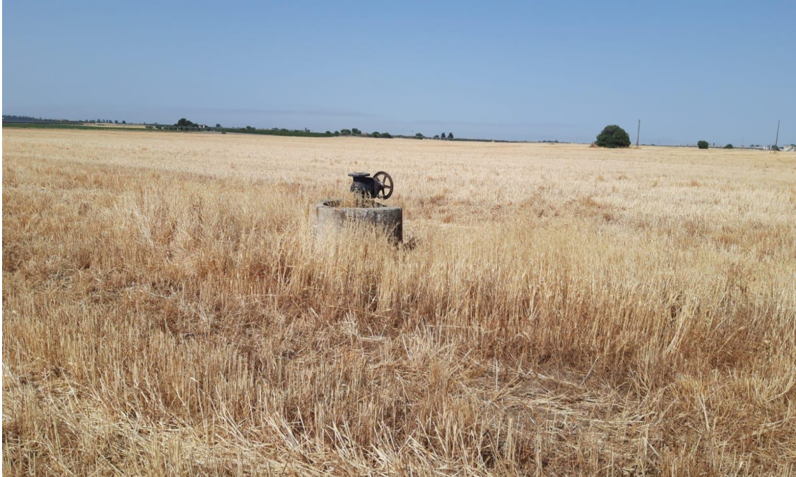
Idrante rete irrigua Consortile
