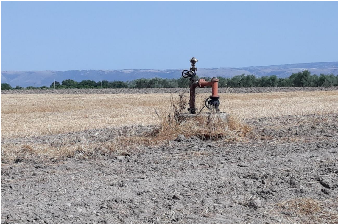
Impianto irriguo: presa aziendale con contatore (Consorzio Bonifica di Capitanata)
