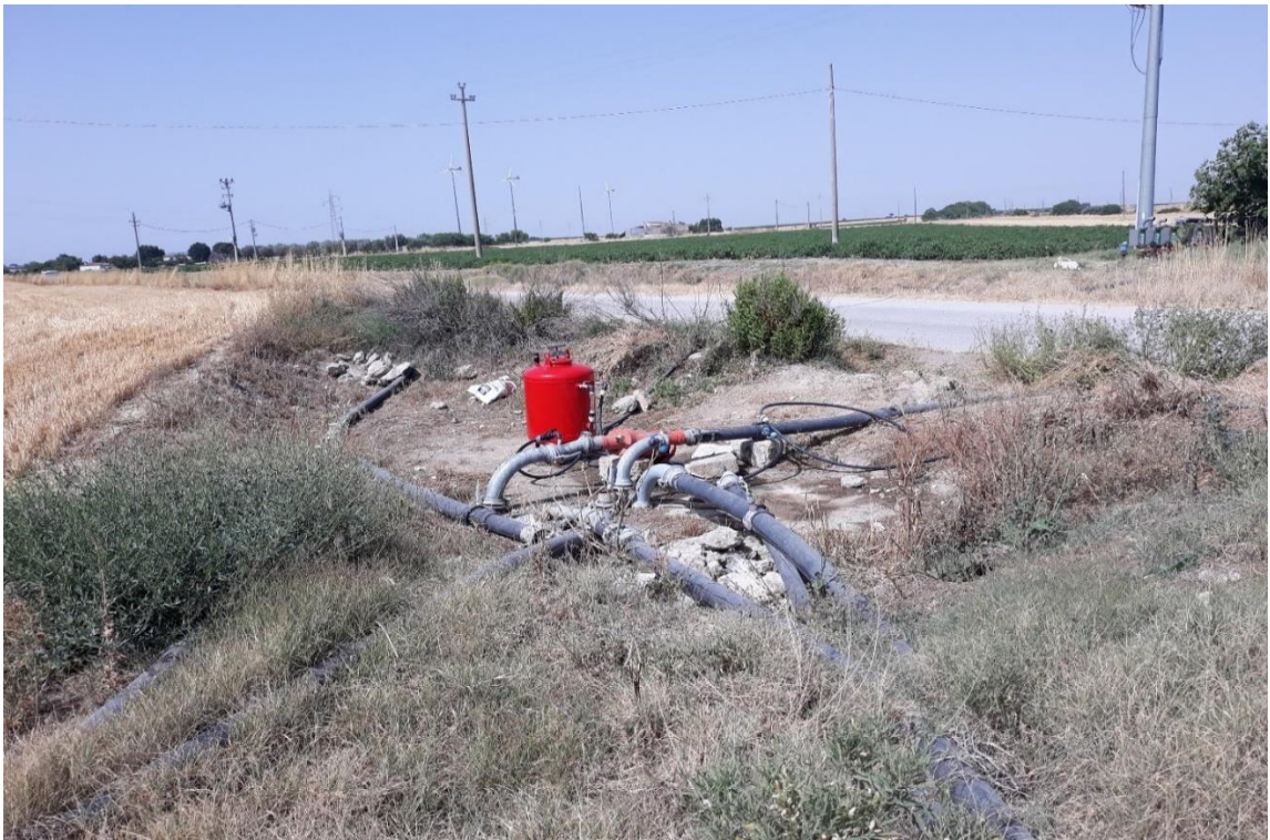
Impianto irriguo: area di erogazione - gruppo elettropompa filtro
