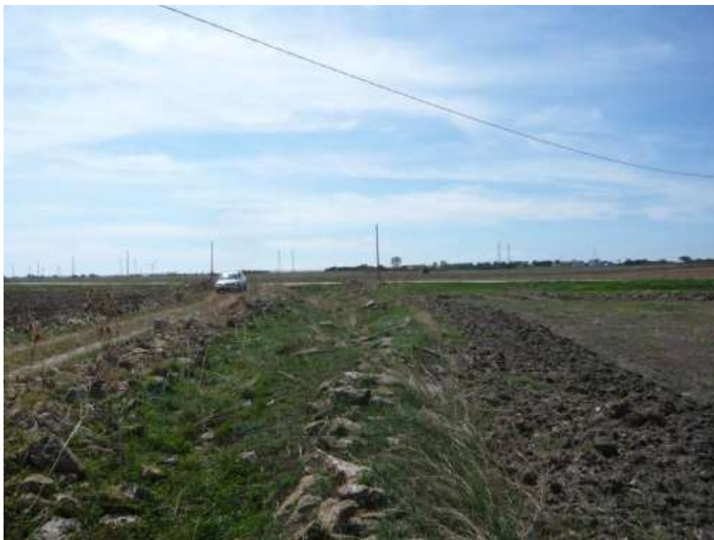
Foto 6.9 – Vista del canale a monte della sezione 23 del Reticolo B , il canale in questo tratto si presenta confinato dalla presenza di muri a secco diruti.
