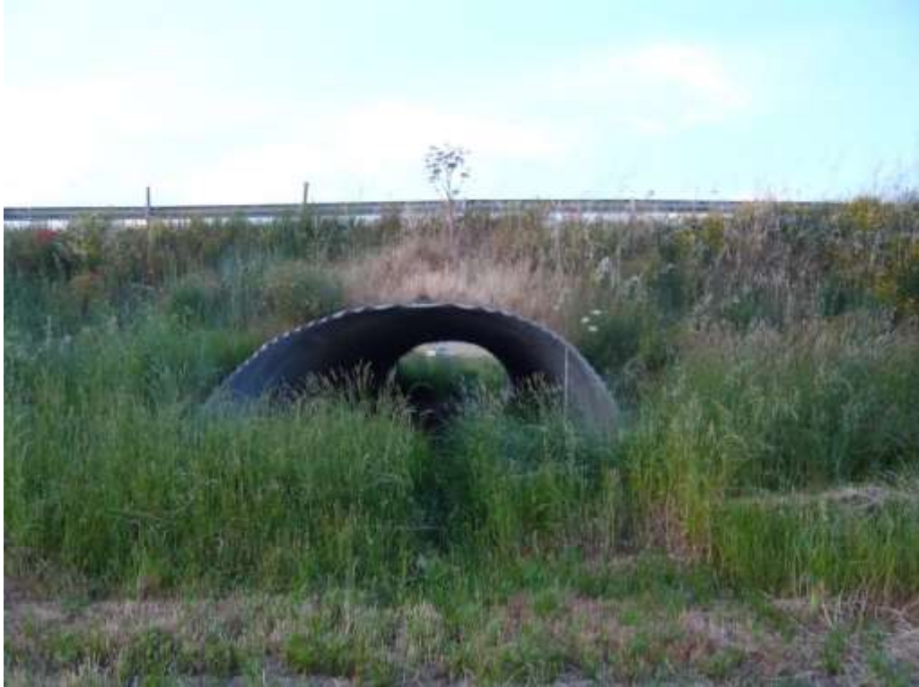
Foto 6.7 – Vista del tombino di attraversamento della SP 140, nei pressi della sezione 64 del Reticolo E .
