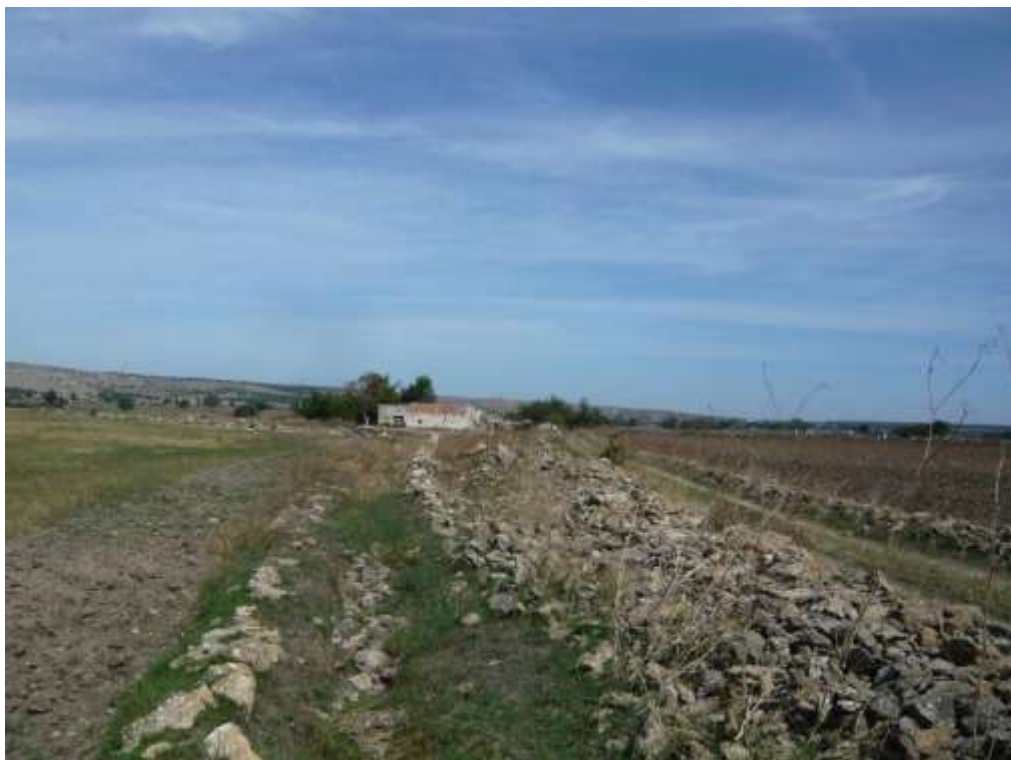
Foto 6.11 – Vista del canale a monte della sezione 21 del Reticolo B , il canale anche in questo tratto si presenta confinato dalla presenza di un muro a secco diruto.
