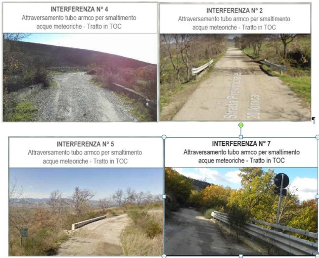
Figura 42: Interferenze con i tubi Armco
