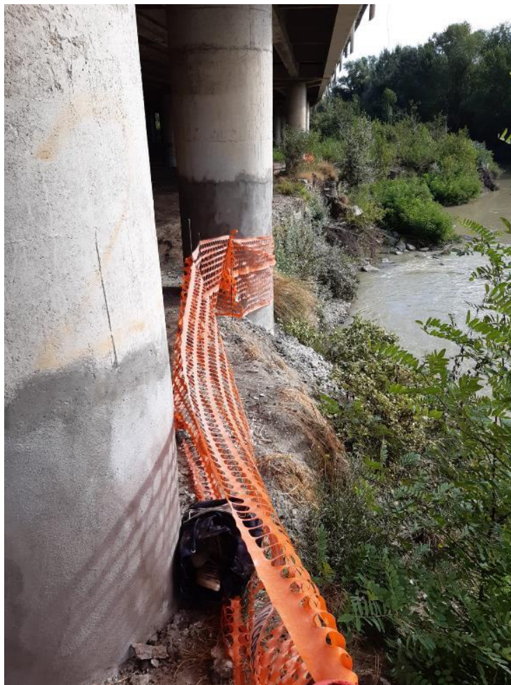
Figura 5-25 - Alveo attuale del F. Reno (foto 09/2020: particolare dei fenomeni erosivi attivi che arrivano a lambire le fondazioni dell'impalcato della tangenziale.
