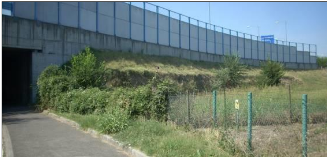
Figura 5-46 – Rilevato artificiale con altezza media di 3-4 m circa relativo al muro di contenimento con funzione portante del sistema tangenziale in esercizio (località Croce del Biacco).
