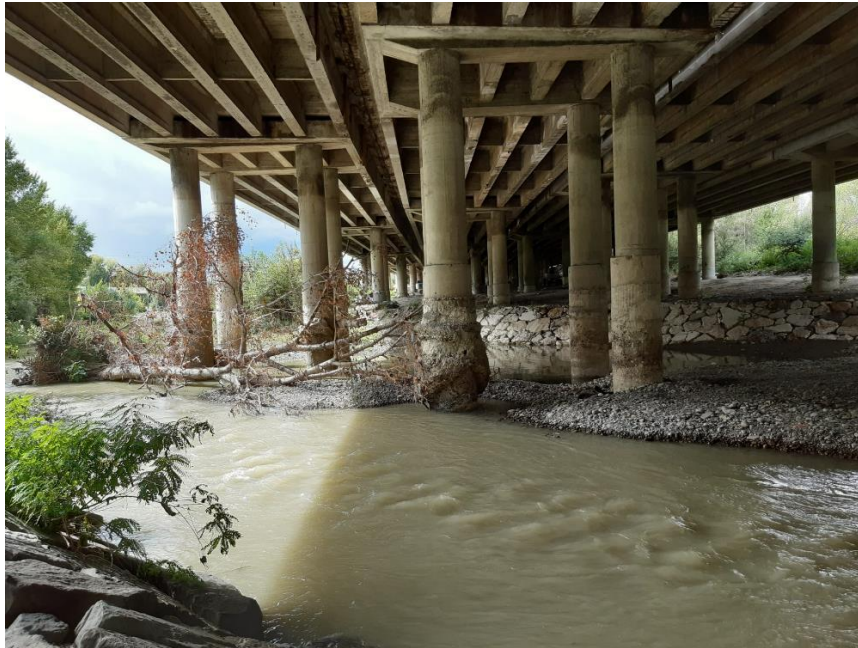
Figura 5-27 - Scalzamento delle pile in alveo del Viadotto Reno (foto 09/2020).
