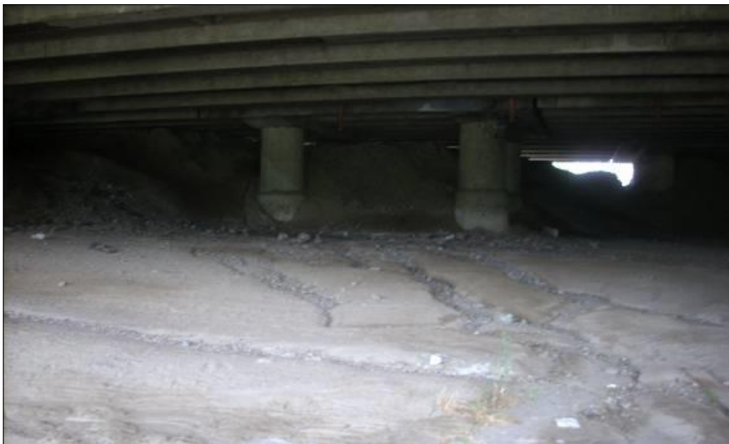
Figura 5-30 - Alveo attuale del F. Reno: erosioni superficiali attive legate al ruscellamento concentrato; l'acqua proviene dal sistema tangenziale in esercizio; in secondo piano s'intravede il profilo dell'argine idraulico destro.
