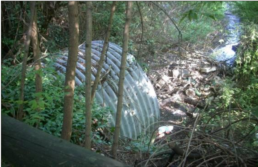
Figura 5-34 - Alveo Savena Abbandonato, si noti il tubo corrugato con un diametro di 1.5m per l'attraversamento.
