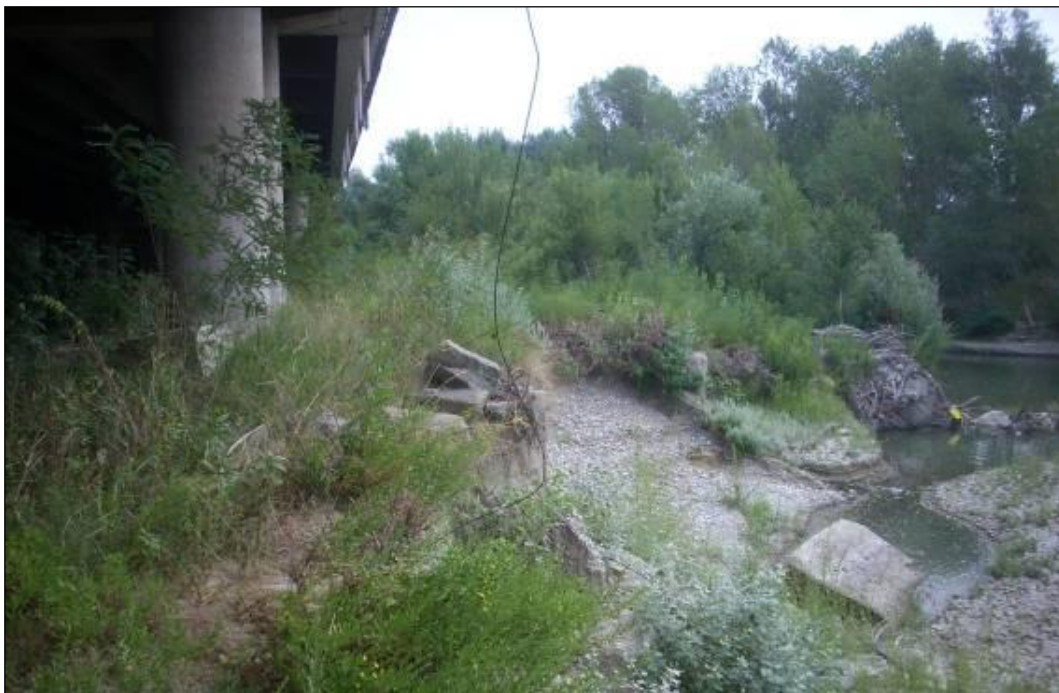
Figura 5-24 - Alveo attuale del F. Reno (foto 2016): particolare dei fenomeni erosivi molto attivi sulle scarpate e prossimi alle fondazioni dell'impalcato della tangenziale.
