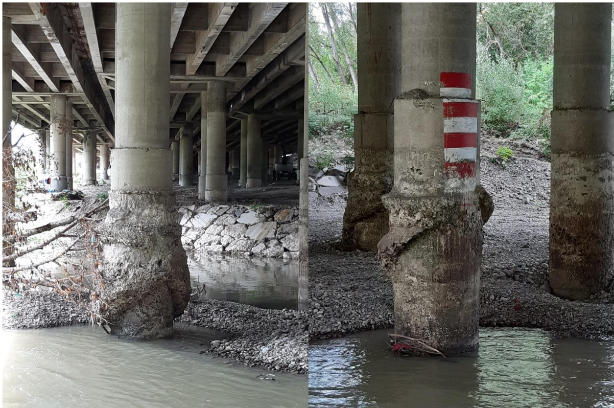
Figura 5-28- Scalzamento delle pile in alveo del Viadotto Reno (foto 09/2020).
