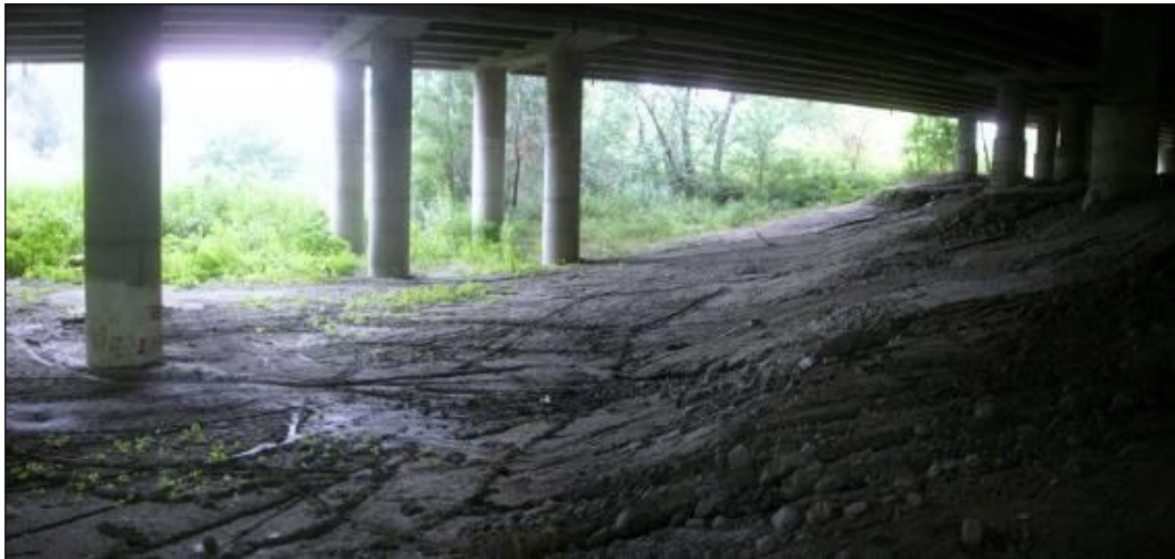
Figura 5-29 - Alveo attuale del F. Reno: erosioni superficiali attive legate al ruscellamento concentrato; l'acqua proviene dalle banchine del sistema tangenziale in esercizio; a destra della foto si vede il profilo dell'argine idraulico sinistro.
