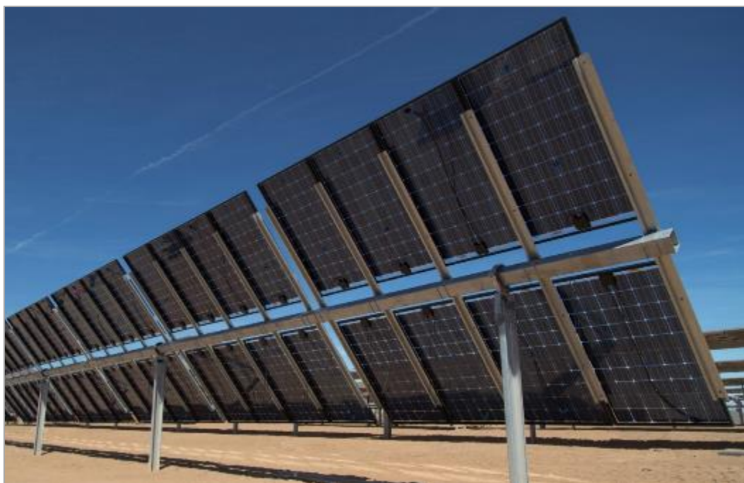
Figura.3- Esempio struttura + modulo FV bifacciale
