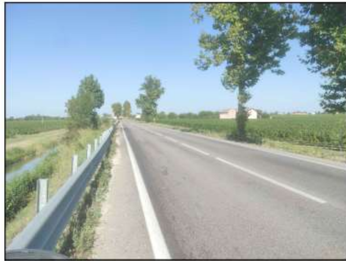
Figura 36 – Dettaglio dello stato attuale con i cedimenti della sede stradale in lato sinistro
