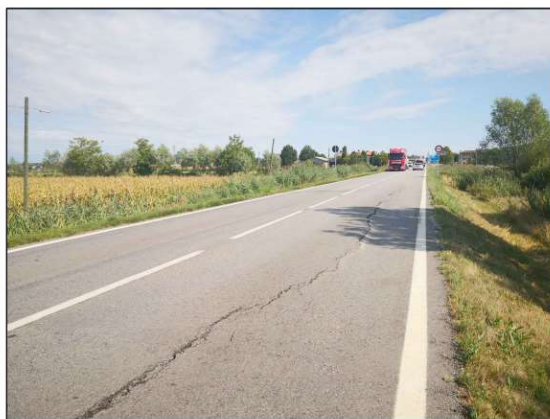
Figura 30 – Dettaglio dello stato attuale con i cedimenti della sede stradale in lato destro
