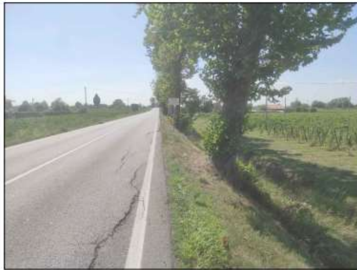
Figura 32 – Dettaglio dello stato attuale con i cedimenti della sede stradale in lato destro
