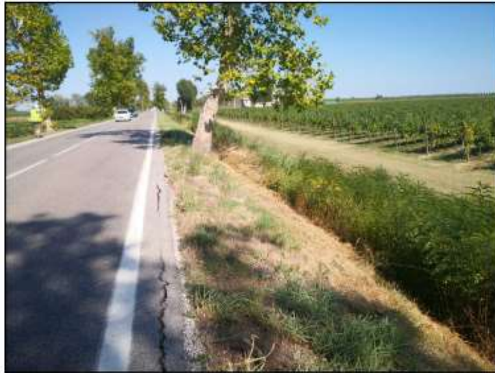
Figura 34 – Dettaglio dello stato attuale con i cedimenti della sede stradale in lato destro
