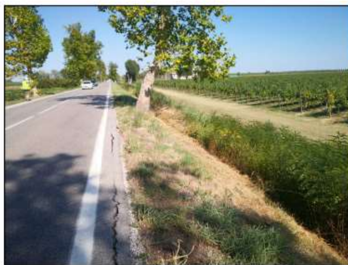
Figura 8 – Dettaglio dello stato attuale con i cedimenti della sede stradale in lato destro
