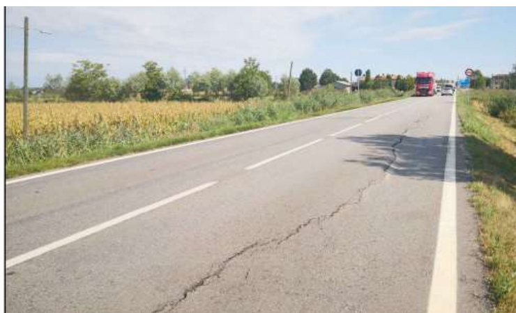
Figura 4 – Dettaglio dello stato attuale con i cedimenti della sede stradale in lato destro
