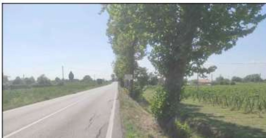
Figura 6 – Dettaglio dello stato attuale con i cedimenti della sede stradale in lato destro
