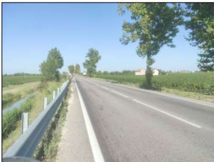
Figura 10 – Dettaglio dello stato attuale con i cedimenti della sede stradale in lato sinistro
