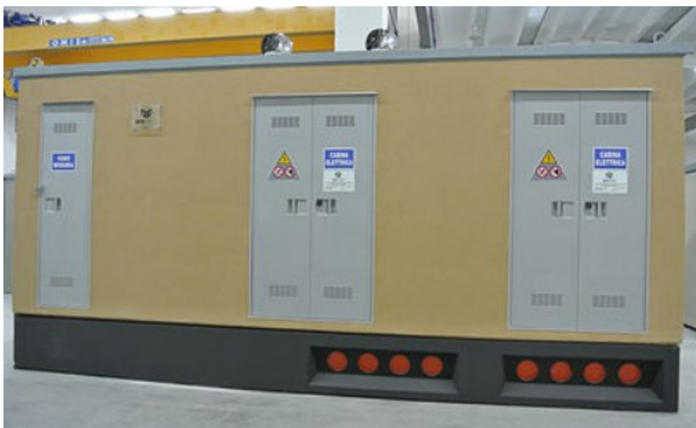
Figura4-Cabina di consegna e-distribuzione DG2092
