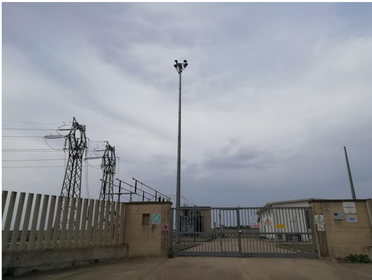
Figura 6 – Vista Cabina Primaria San Pancrazio Salentino
