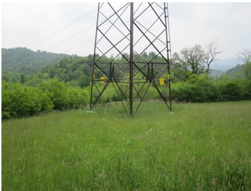
Figura 7 Intervento di inerbimento sulle linee 132 kV della Val D'Ossola Sud
