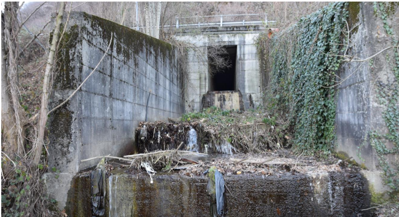
Figura 4 – Sblocco del tombino idraulico al di sotto della SS36
