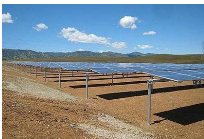
Figura 1 - Tracker impiegato per il supporto dei moduli fotovoltaici
