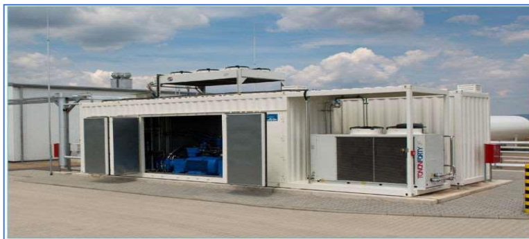
Compressore a idrogeno ad alta pressione
