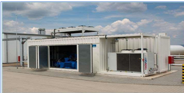
Compressore a idrogeno ad alta pressione
