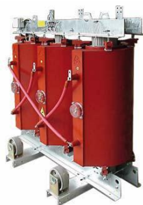
Figura 3: Trasformatore di elevazione BT/MT da 2500kVA
