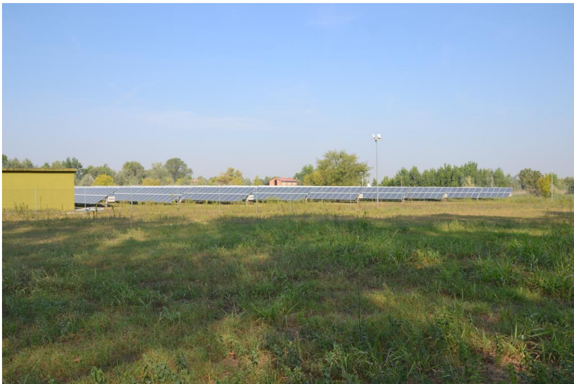
Figura 33. Impianto fotovoltaico a terra presente a 500 m N dal bacino lacuale nord. Fonte: rilievo fotografico ENVIarea (ottobre 2021)
