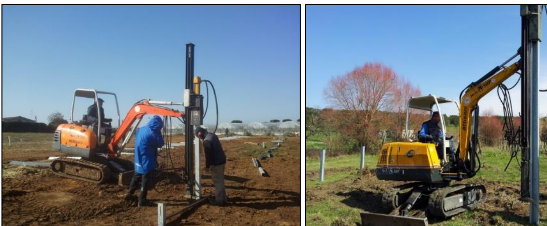
Figura 64 - Tipologia di installazione delle strutture di sostegno dei moduli FTV con macchina battipalo
