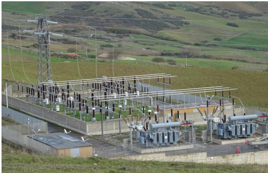
Figura 4-1: Vista aerea della sottostazione.
