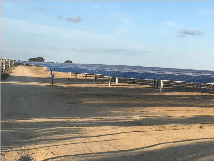
Figura 5 – impianto con viabilità interna
