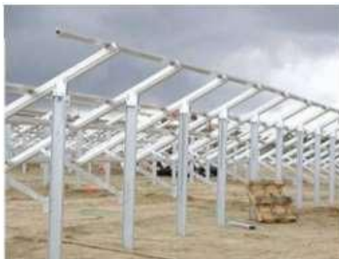
FIGURA 23 - STRUTTURE DI SOSTEGNO (TRACKER)
