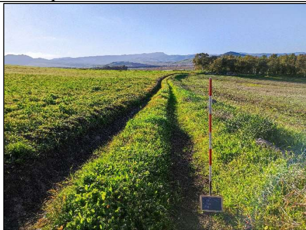
Cavidotto di collegamento all'impianto
