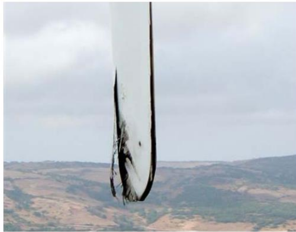
Figura 13 estremità di pala danneggiata da fulminazione atmosferica
