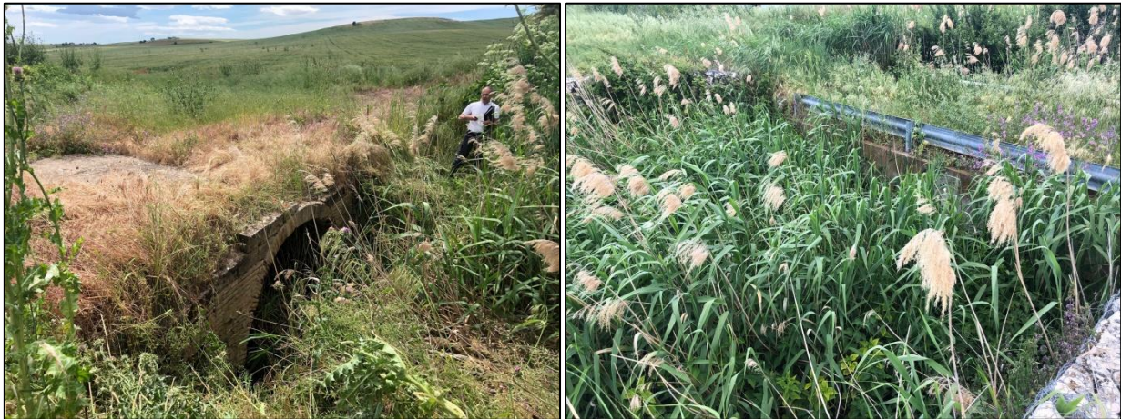
Figura 22 –Torrente Capacciotti – Particolari della vegetazione in alveo e a ridosso dei manufatti esistenti
