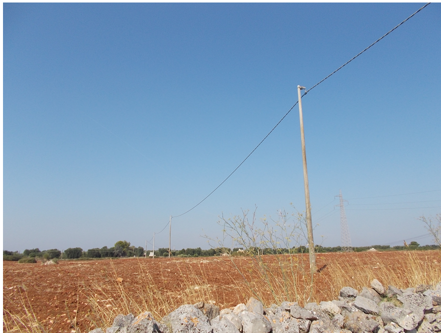
Linea MT aerea interferente con le aree di Impianto
