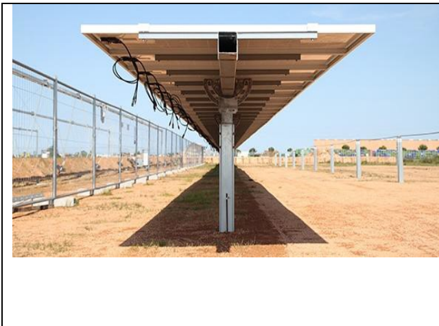
Inseguitore fotovoltaico mono assiale
