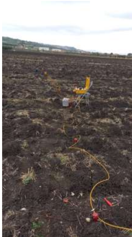
FOTO 7: postazione di energizzazione SS4
