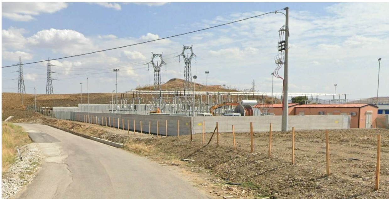
Fig. 01 - stazione di utenza AT/MT
