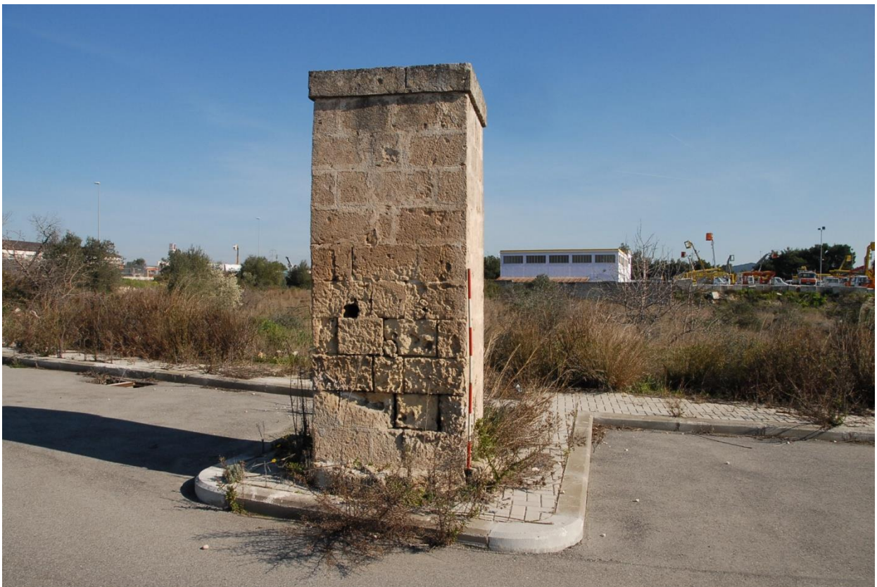
Figura 13: area adiacente la provinciale Statte - Taranto, sfiatatoio dell'Acquedotto del Triglio
