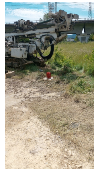
Pozzetto di protezione Sondaggio C S05 Bis
