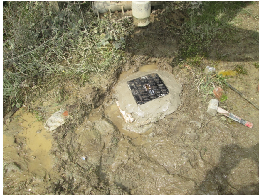
Pozzetto di protezione carrabile del Foro di Sondaggio C S02 attrezzato con Tubo Piezometrico
