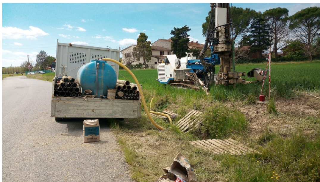
Postazione Sondaggio C S01
