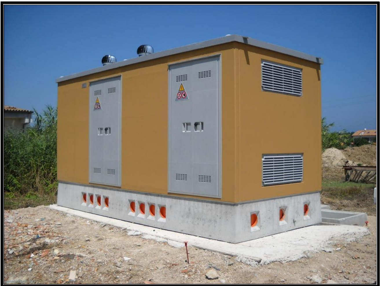
Figura 13 - ESEMPIO DI CABINA DI PARALLELO MT
