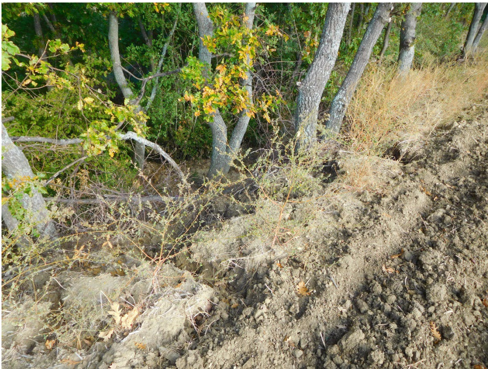
Figura 1-34. Tratto in erosione
