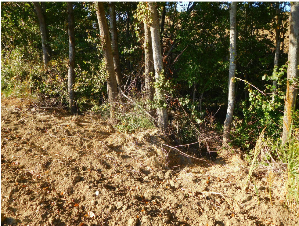
Figura 1-32. Tratto in erosione
