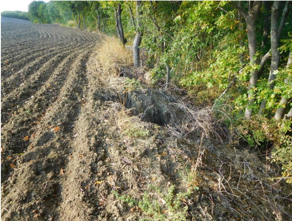
Figura 1-33. Tratto in erosione
