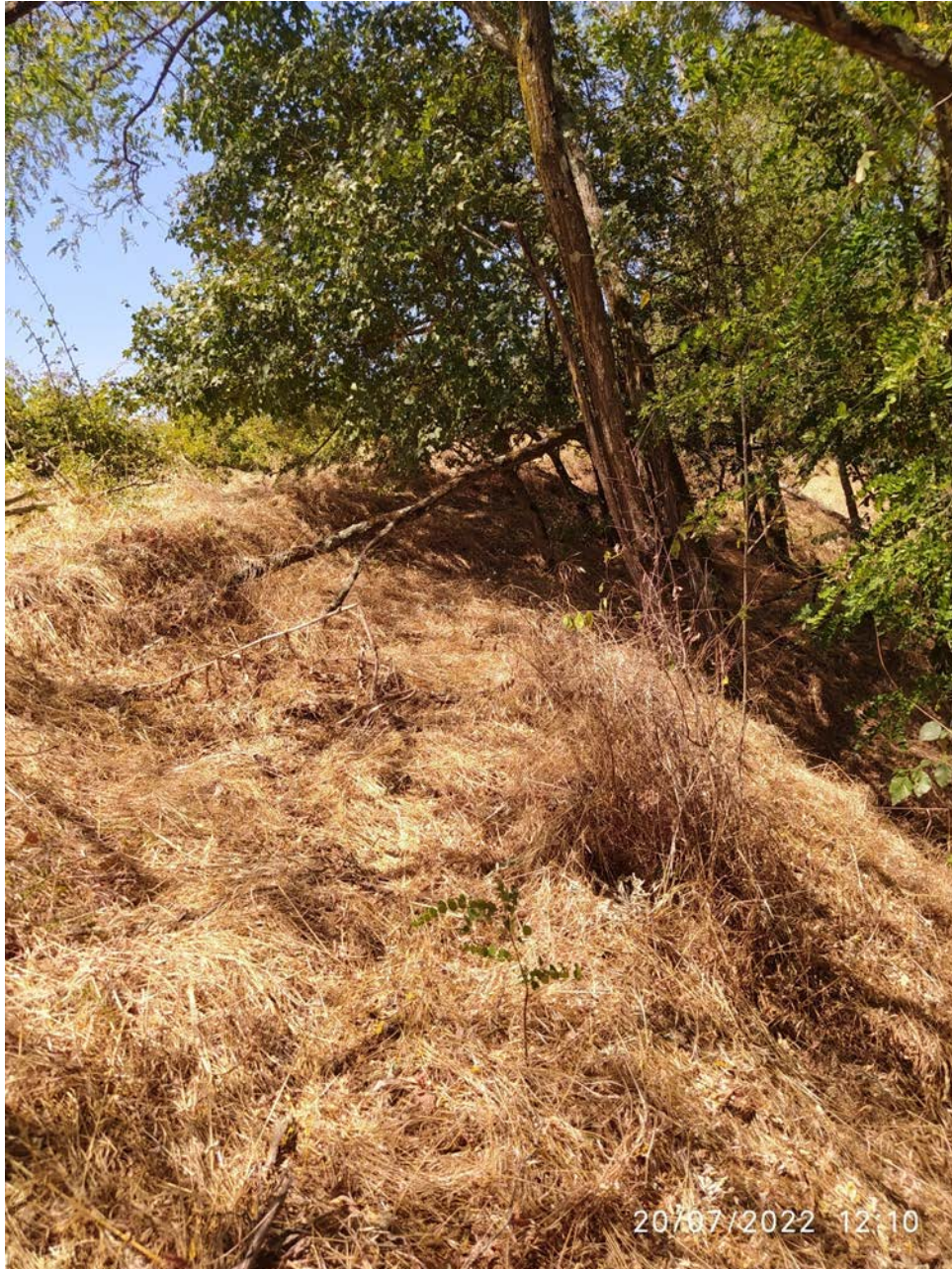
Figura 29 - Orlo di scarpata con alberi inclinati verso monte e gradino retrostante.
