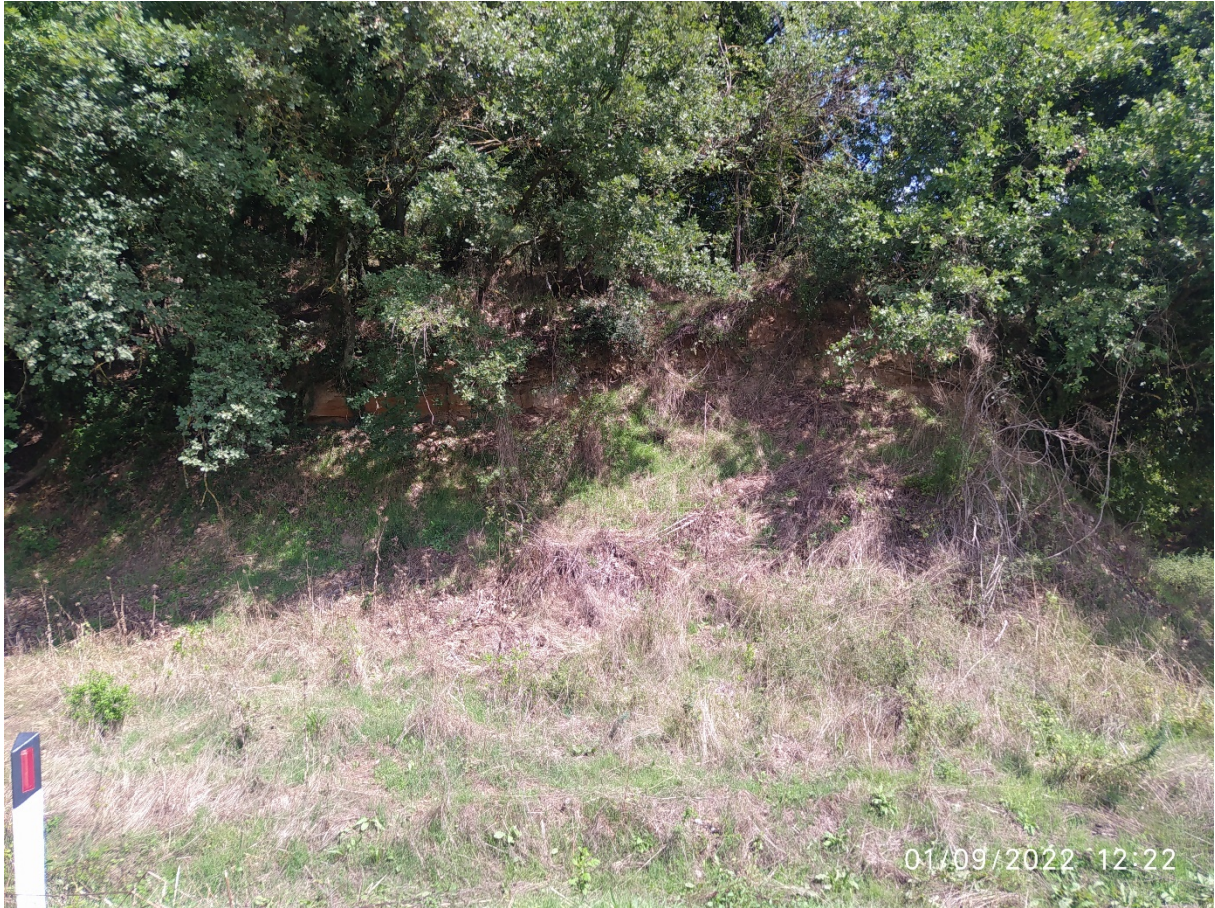
Figura 17 - Raccordo tra riporto minerario e Sabbie di Levane con sviluppo di scarpata di erosione da regolarizzare.
