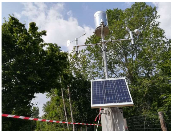
Foto g: Meteo vista in direzione W
