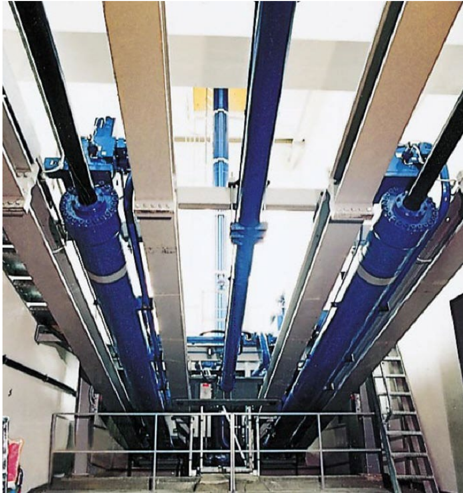
Figura 8.3: sistema di tensionamento idraulico costituito da n.2 pistoni in parallelo già in uso
