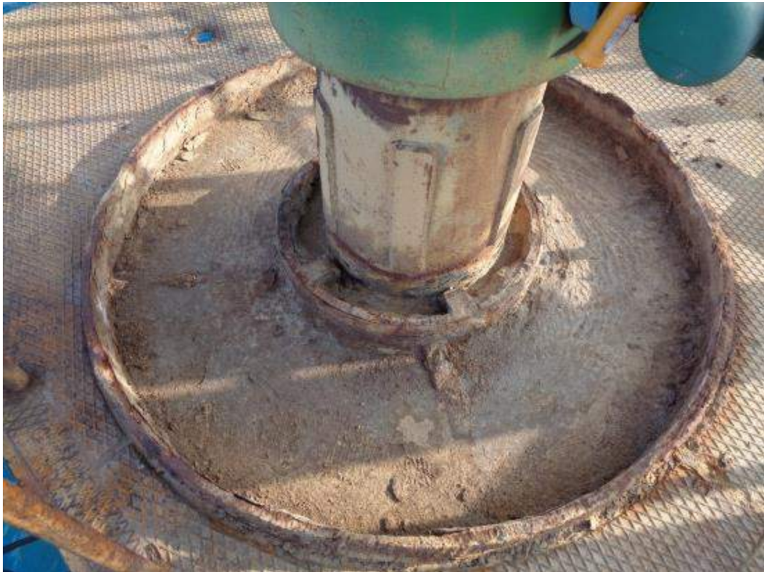
Figura 3-2 – Armida 1 – Particolare cementazione all'interno della monotubolare
