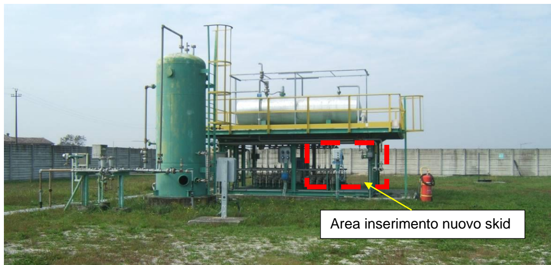
Figura 1-E - Vista Area Metanolo dove verrà installato il nuovo skid d'iniezione coperto da tettoia metallica
