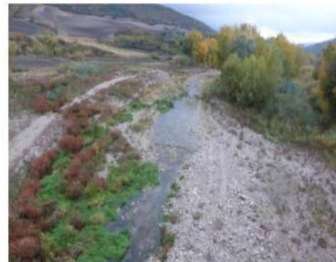
Lavori di arginatura sul T. Cervaro (CA_CE01). Ripresa della vegetazione spontanea dopo abbattimento della fascia perfluviale - 14 novembre 2017
