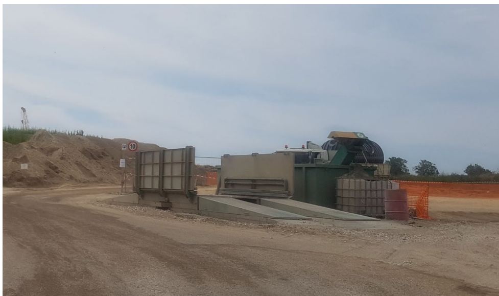
Figura 64 Esempio di impianto automatico lavaggio ruote mezzi d'opera
